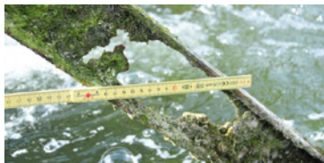
Durchgerostete Stahlstützen bei der Wehrkonstruktion
