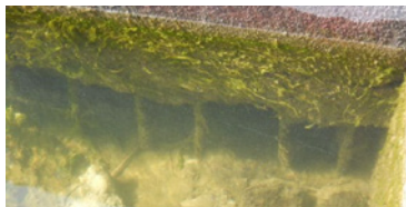
Freigelegte Armierung im Bereich des linksseitigen Überfalls
